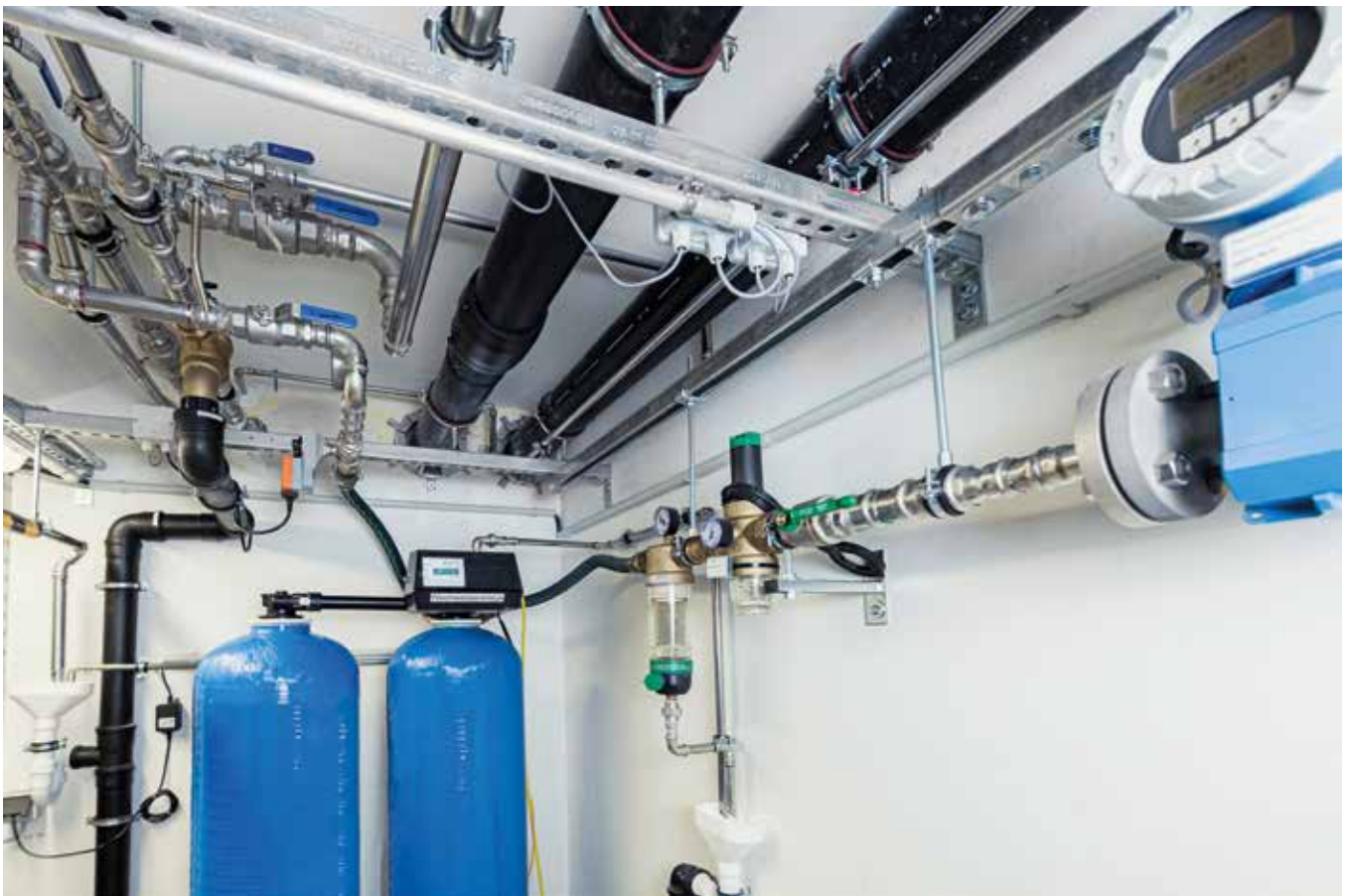
› Doppelenthärtungsanlage zur Entfernung der kesselsteinbildenden Minerale und Dosierstation für korrosionshemmende Inhibitoren, integriert in eine Container-Kühlanlage
